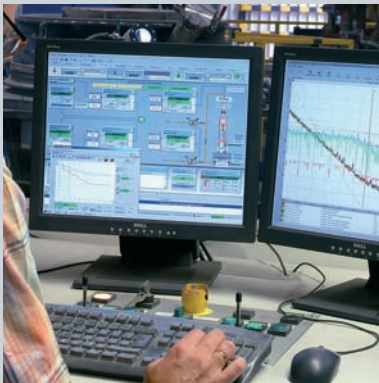
Redundantes Prozessleit- und Visualisierungssystem Redundant process control and visualisation system
